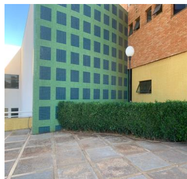
Imagem 04 - Local para alocação das condensadoras
